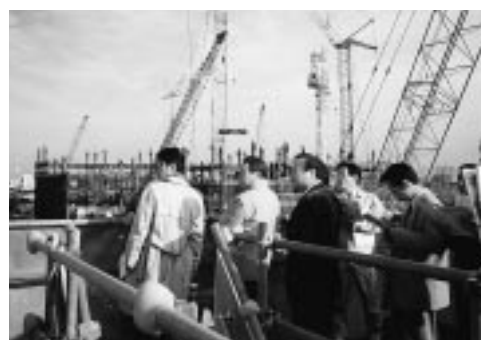
平成15年の完成を目指し 工事が進む SKIPシティ建設現場
